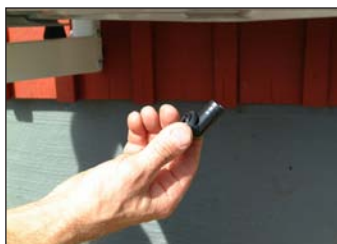
30. Bifogad rörkoppling, som ska sitta under utedelen, ska inte monteras. Den orsakar isbildning och kan ställa till problem. Bättre utan!
