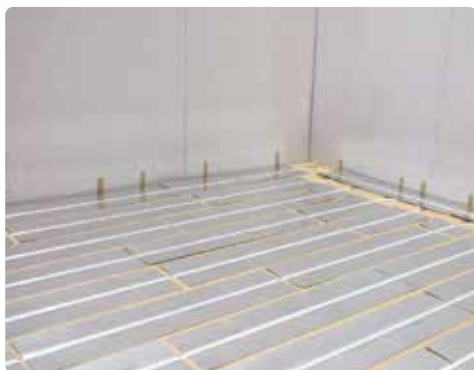
17. Installationen är klar.
