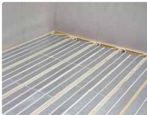
12. Installationen är klar.
