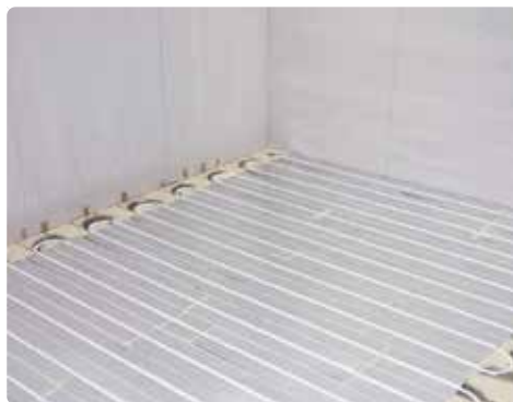
26. Installationen är klar.
