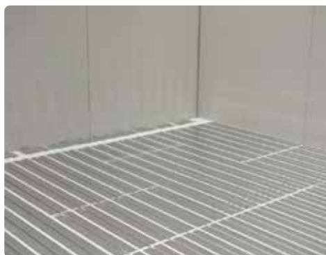
12. Installationen är klar.
