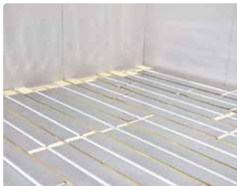
12. Installationen är klar.
